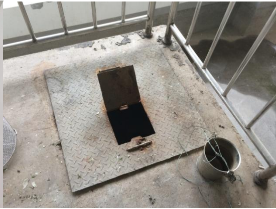
进水手工监测取样点
